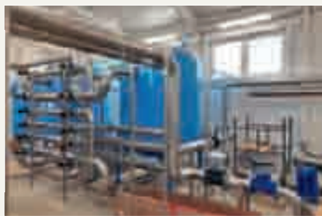
Stacja uzdatniania wody w Przecznie
